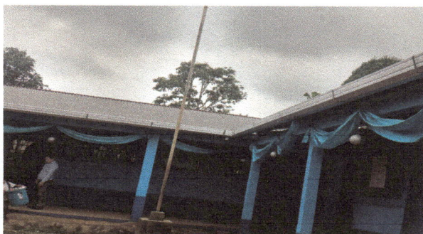
Foto 1: Los canales instalados actualmente
